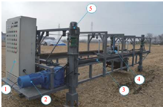
1: 控制柜; 2: 牵引电动机; 3: 悬架导轨; 4: 多功能台车; 5: 升降电动机
